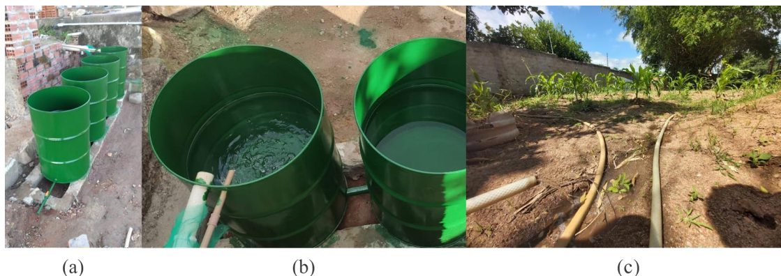
Figura 7. Sistema em operação: (a) - (b) captação de água de descarte e (c) irrigação da horta frutífera. Fonte: autoria própria (2022).
